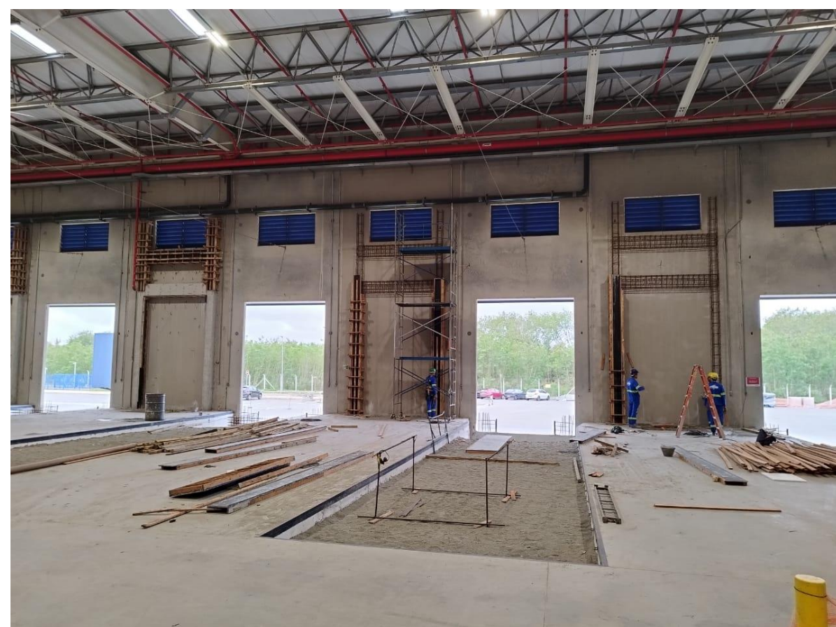
Foto 01 – reforço no painel Tilt Up , para abertura das novas docas entre as antigas siders
