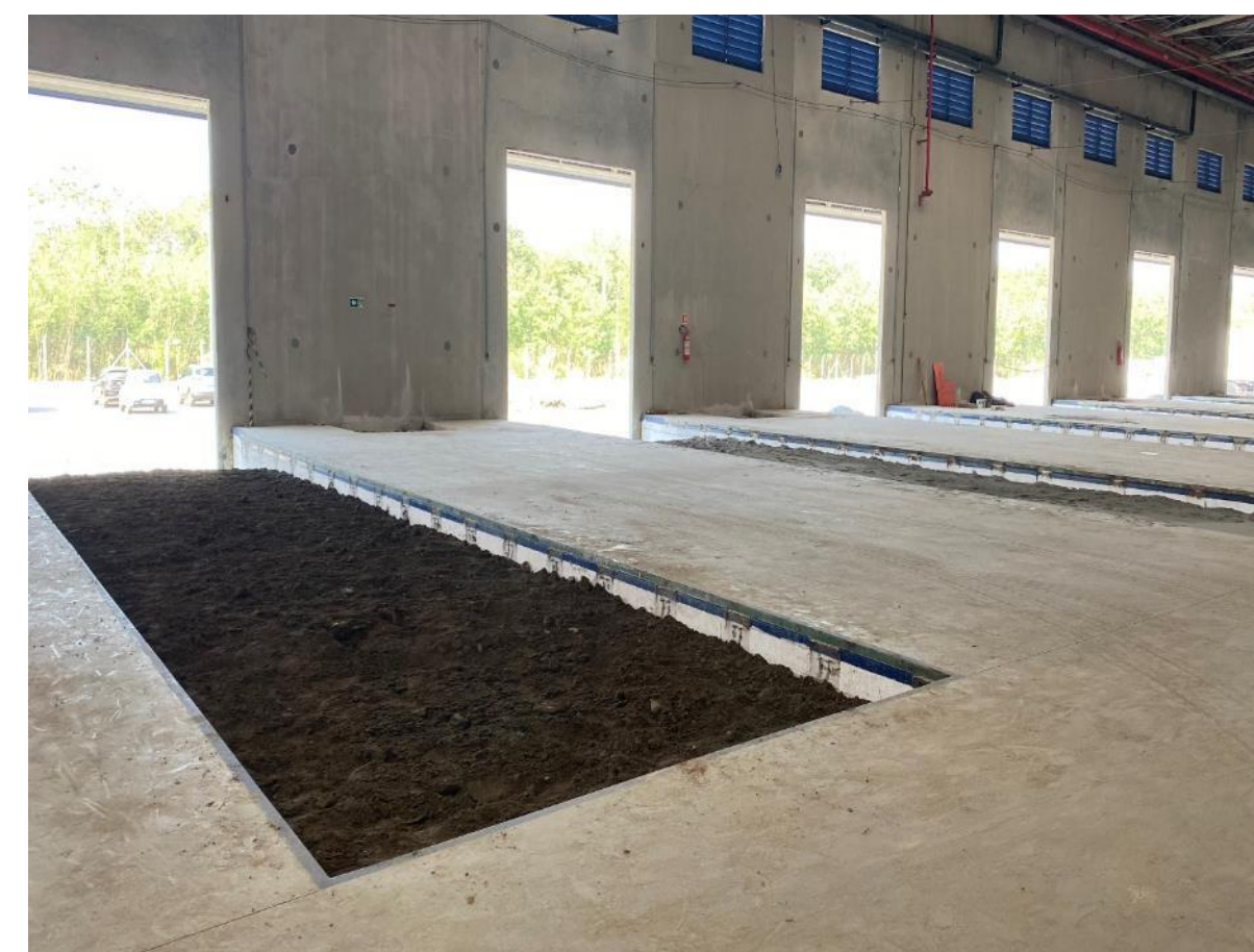
Foto 03 – compactação de aterro nas docas sider para execução de piso de concreto
