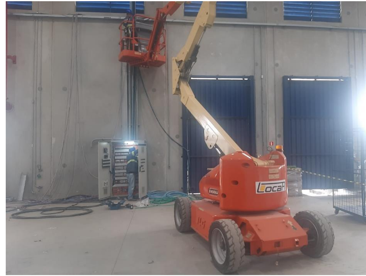
Foto 05 – relocação do painel elétrico e alteração dos circuitos elétricos para nova modulação
